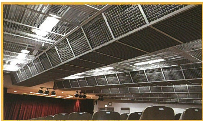
空調設備（レクチャーホール）
