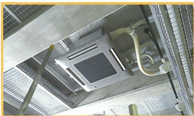
更新された空調機器
