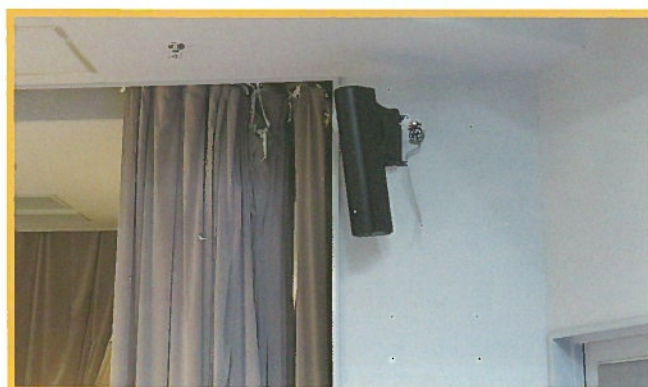
コンパクトになったレクチャーホール内メインスピーカー
